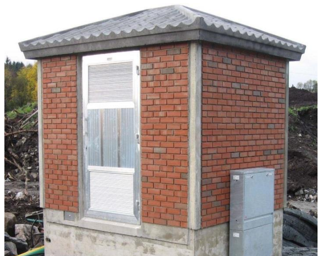
Figur 10. Mini A nettstasjon i betong
