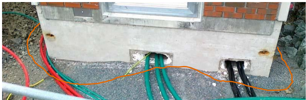
Figur 21. Ringjord rundt betong nettstasjon
