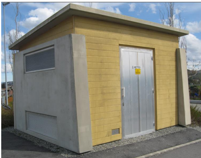
Figur 9. Lyse Maxi nettstasjon i betong
